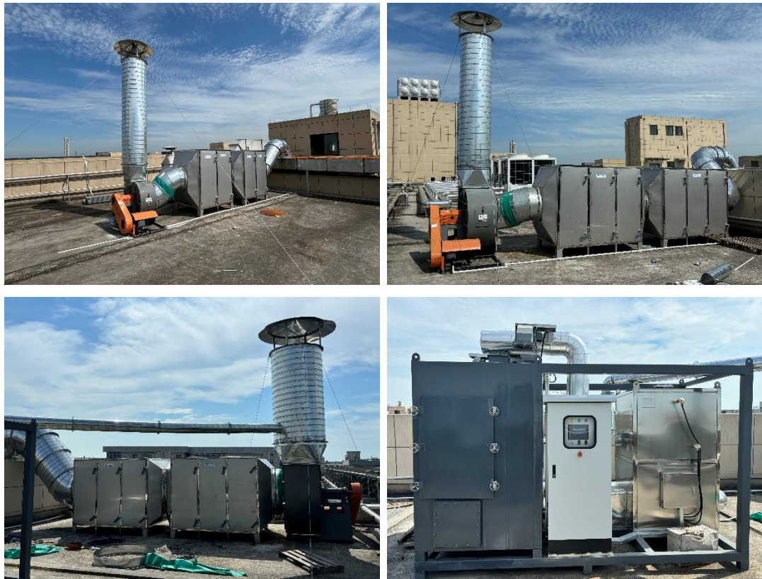
图 3-2 废气处理设施现场照片
