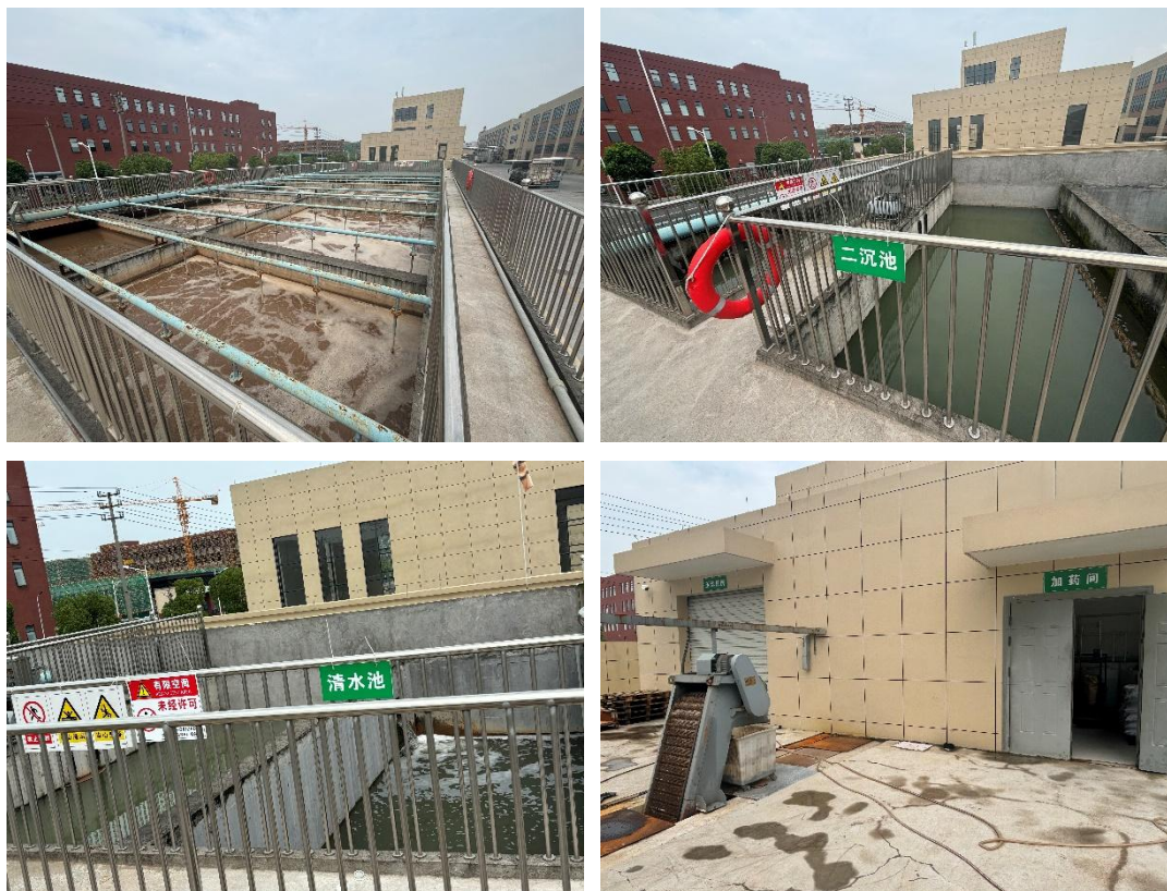
图 3-1 废水处理设施现场照片
